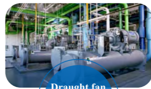
Draught fan & Water pump
